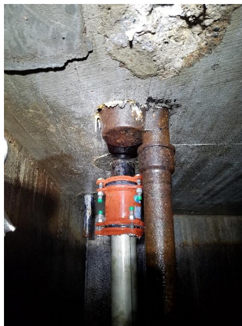
Figur 5. Tak i lågreservoar. Avlopp från produktionslokalen (golvvbrunn och ledning i gjutjärn)
