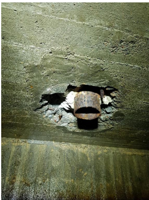
Figur 4. Tak i lågreservoar. Genomföring där renat vatten släpps ner, betong i tak vittrar sönder.
